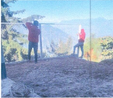
Foto1: Sustitucion de maya y acabado de circulación y puerta de 1m 20cm
